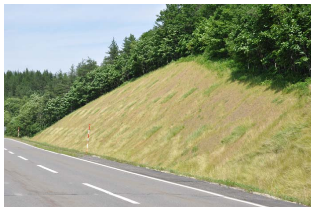
ミヤコザサを用いて緑化された道路のり面 (国道336号線大樹町紀文沼地区)
